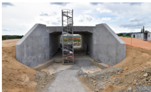
Chantier des créneaux de dépassement de la RN147, entre Bellac et Limoges (photo prise en avril 2023)
