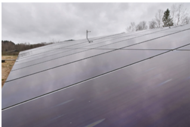
Parc photovoltaïque de Saint-Brice-sur-Vienne
